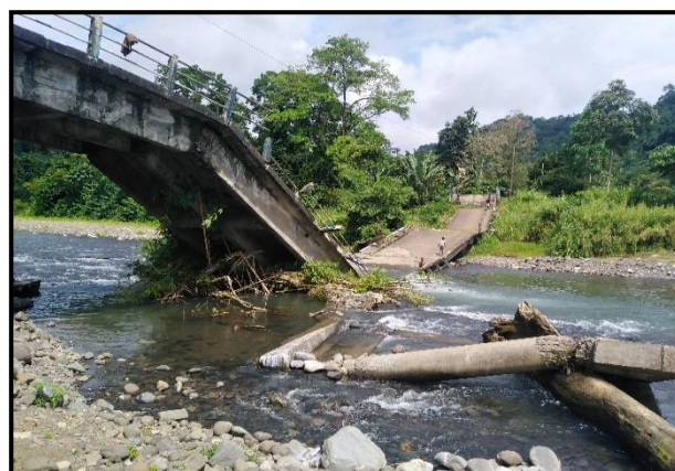
Fotografia 2 : Foto 3: Convés desmoronado e apoios deslocados ou em falta
