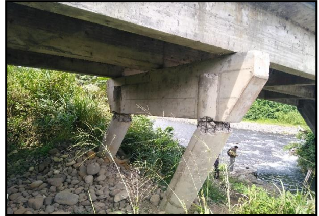
Fotografia 4 Cais muito deformado e degradado
