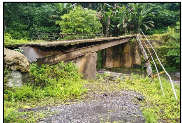
Fotografia 6 Foto 6: Tabuleiro degradado e pilar tombado
