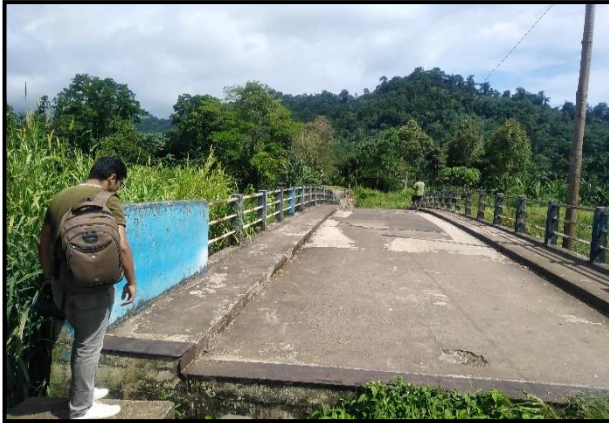
Fotografia 3 Foto 4: Grande abertura na junta de dilatação e deslocação do tabuleiro
